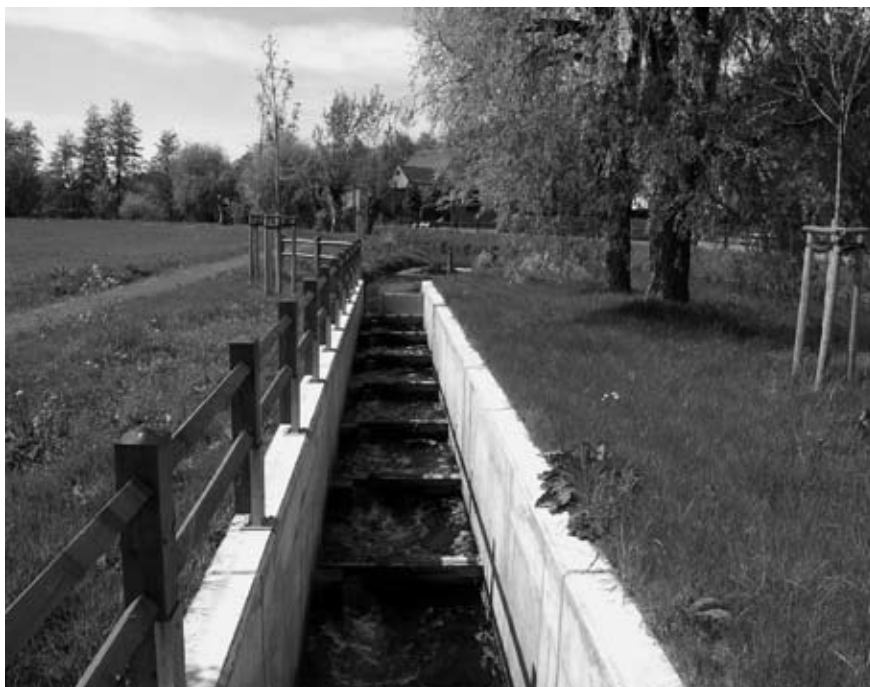
Bild 6: Schlitzpass am Wehr Großstöbnitz
